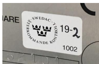
Bild 1: Märkning som visar att återkommande kontroll utförts i februari år 2019.
